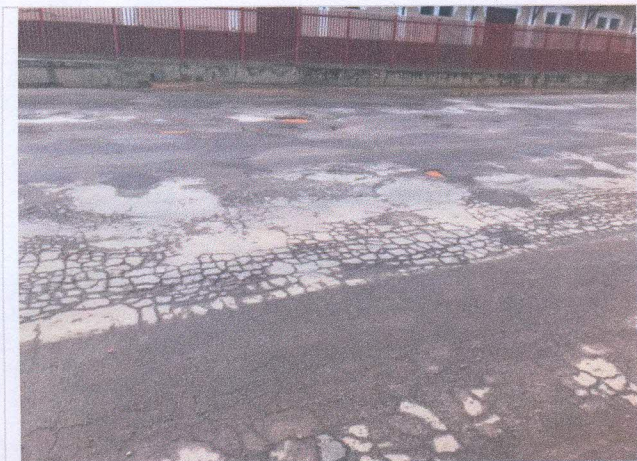
Foto 07 Base de pavimentação danificada
