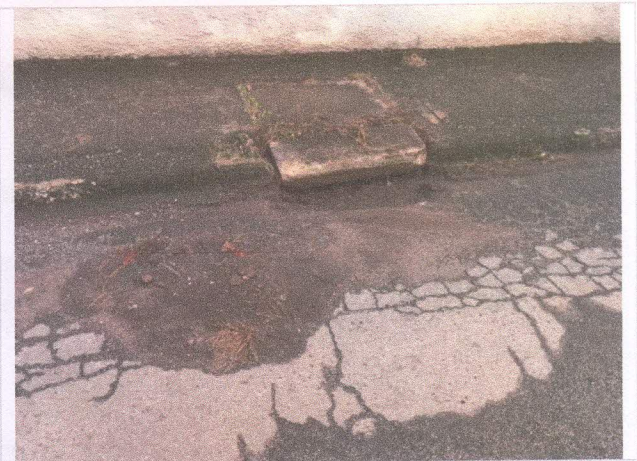
Foto 08 Sistema de drenagem insuficiente e danificado
